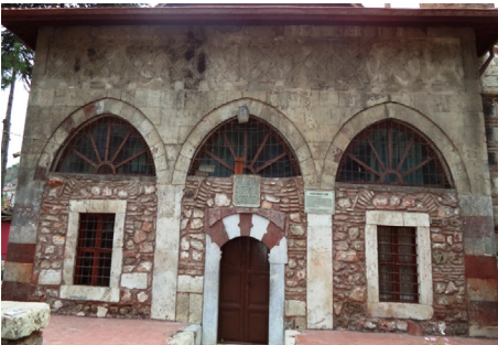
Foto 48: Alaca Mescit, giriş cephesindeki malzeme uyumsuzluğu
