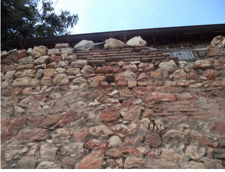
Foto 50: Paşa Hanı, moloz taş-tuğla duvar, çimento kaplamalar
