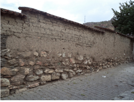
Foto 44: Paşa Hamamı yan duvarda üst tarafta kerpiç kaplama
