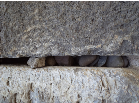
Foto 21: Niksar Akyapı Türbesi, Duvarlarda derz arası
