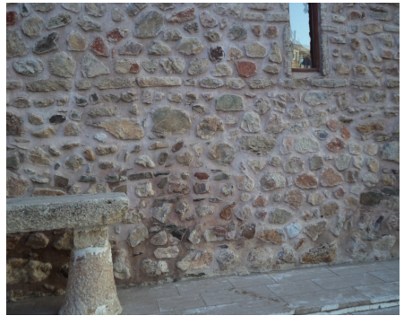
Foto 36: Hamzabey Camisi, Duvarda moloz taşlar
